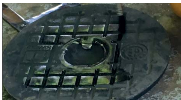
Schachtdeckel ohne Griff in Vorbereitung für die neue Halterung.
